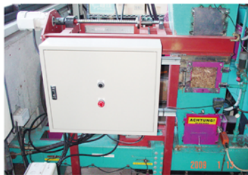
(株)カナックとのPBLで実際に採用された「木質バイオマスボイラの燃料多様化対策」の装置。
